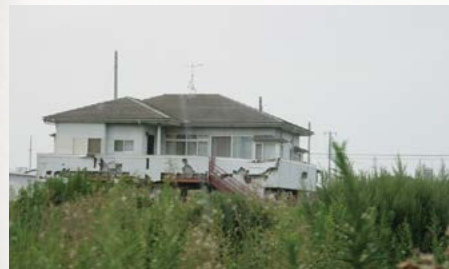
2014年8月：宮城県石巻市大街道地区にある取り壊しの済んでいない住宅
