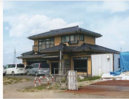
2014年9月：宮城県仙台市宮城野区／1階部分が津波被害に遭った住宅
